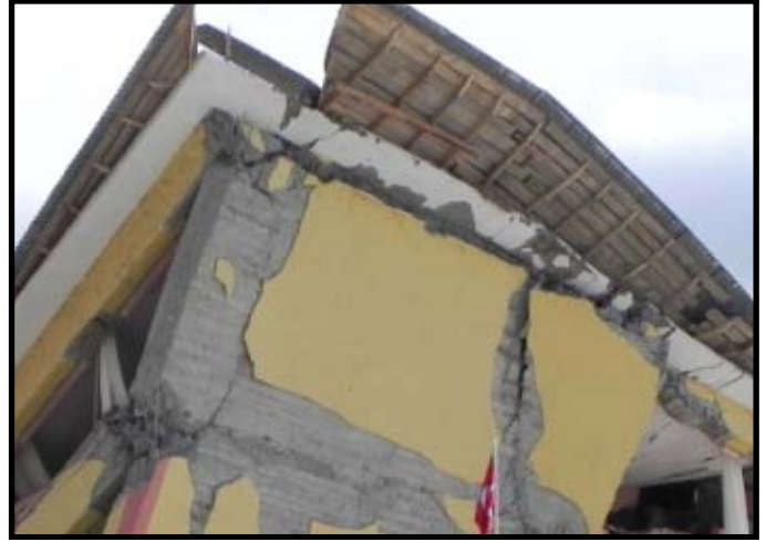
Fotoğraf/Picture 65 – Perde-Döşeme Birleşiminde Ankraj Boyu Zafiyeti ve Yerinden Çıkan Döşeme / Anchorage Failure at Shear Wall to Slab Connection
