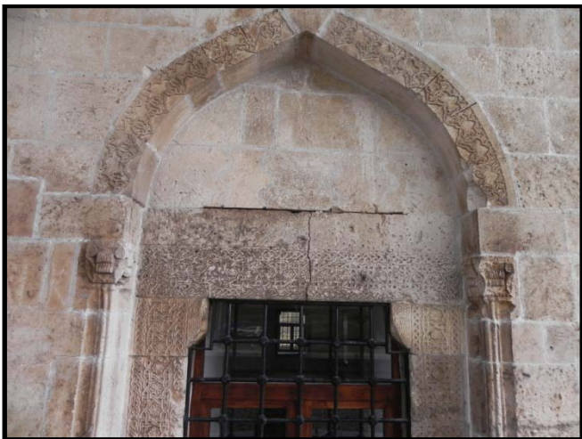
Fotoğraf/Picture 15 – Pencere Üstlerindeki Çatlaklar / Cracks Above the Windows
