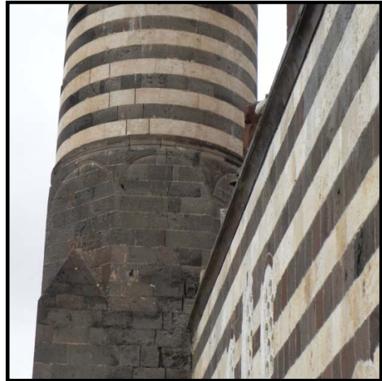
Fotoğraf/Picture 14 – Minarede Derz Oynamaları / Bed-Joint Failures on the Minaret
