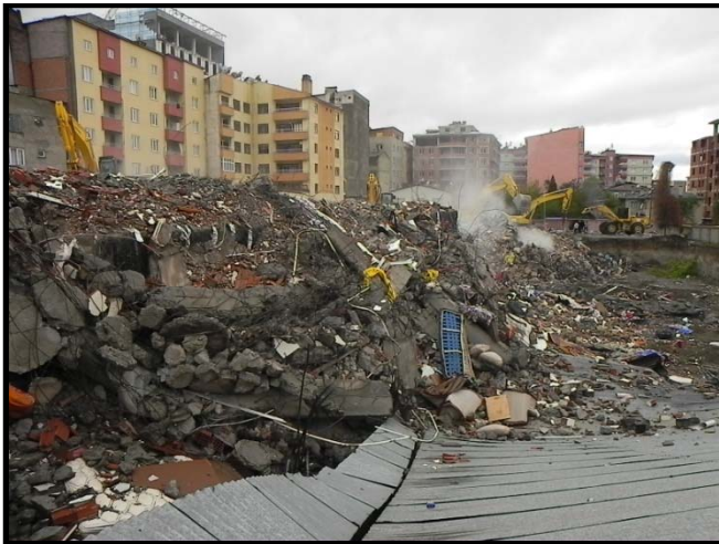
Fotoğraf/Picture 45 – Van Şehir Merkezinde Toptan Göçen Bina Kalıntısı / Rubbles of a Building with Total Collapse in the Van City Center
