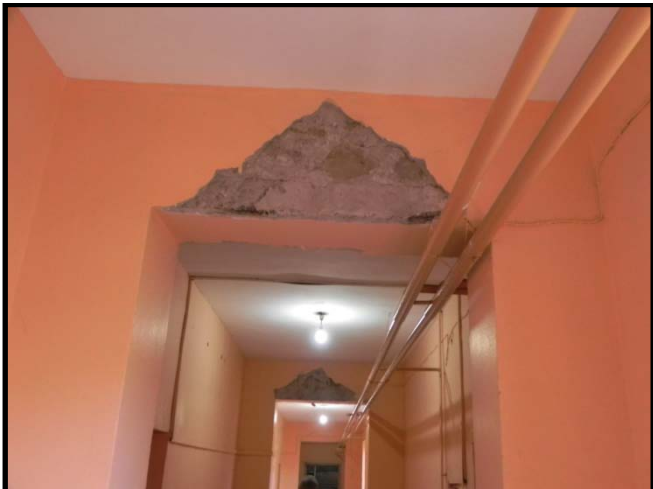
Fotoğraf/Picture 21 – Koridor Kirişlerindeki Hasarlar / Damage on Corridor Beams
