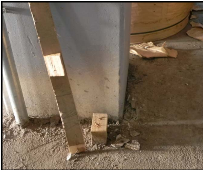
Fotoğraf/Picture 77 – Kolon Tabanında Döşeme Kaplaması Hasarı / Damage on Floor at Column Base
