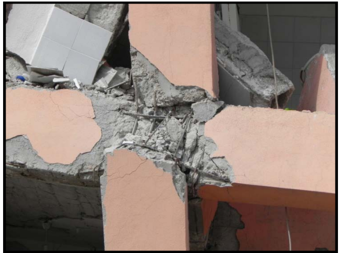
Fotoğraf/Picture 63 – Düğümde Sargı Donatısı Eksikliği / Lack of Joint Hoop Reinforcement
