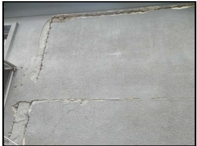
Fotoğraf/Picture 30 – Duvar Hasarları / Damage on Confined Masonry Walls
