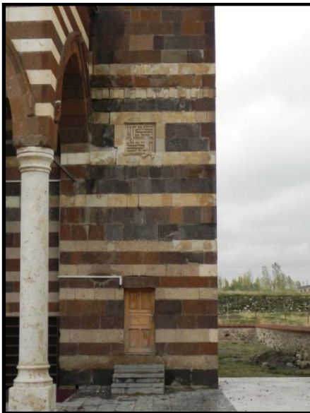
Fotoğraf/Picture 7 – Kaidede Gözlenen kesme Çatlakları / Shear Sliding Cracks on Minaret Pedestal
