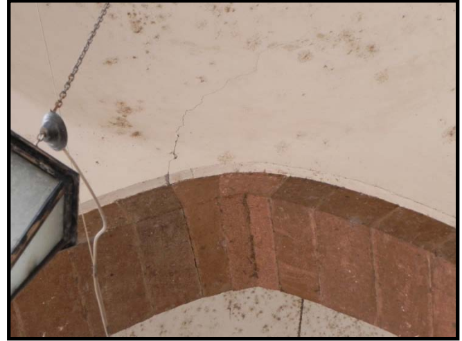
Fotoğraf/Picture 4 – Son Cemaat Kemerlerindeki Çekme Çatlakları / Tensile Cracks on the Arch Crests of the Late Preyers' Porch
