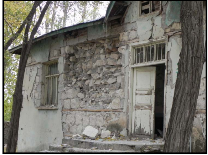
Fotoğraf/Picture 42 – Ön Cephe Gözlenen Taş Duvar Dış Katman Göçmesi / The Failure of the Outer Wythe of the Stone Masonry at Front Face
