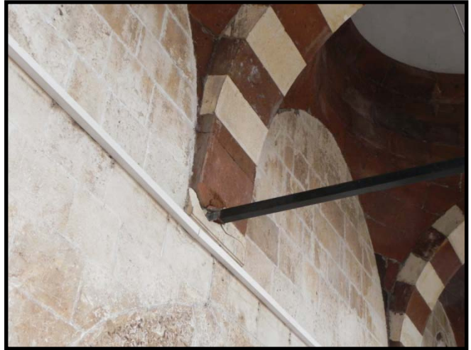
Fotoğraf/Picture 12 – Gergilerde Bağlantı Noktası Hasarları / Pull-out Type of Failures – Tension Ties
