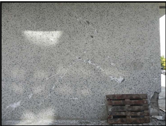
Fotoğraf/Picture 51 – Foto.49 daki Binada Perdede Kesme Çatlakları / Shear failure in the Shear Wall of Bldg. in Pic. 49
