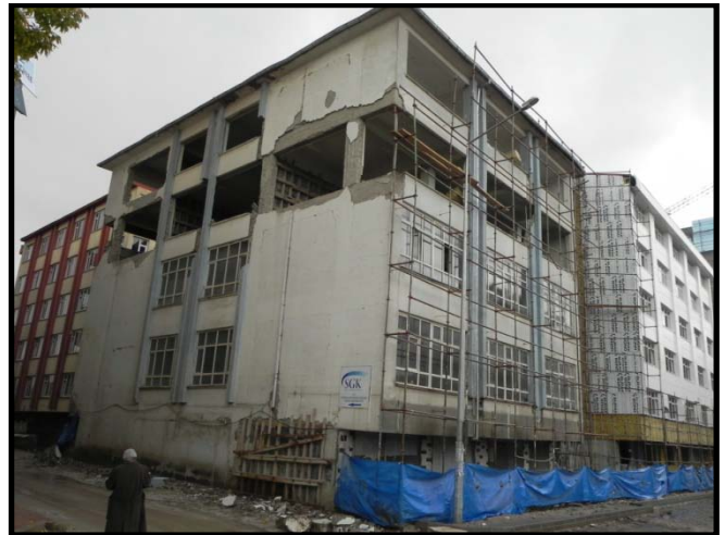
Fotoğraf/Picture 46 – Fotoğraf 45’deki Binanın Karşısında Güçlendirilirken Deprem Geçiren SGK Binası / The SGK Building Opposite to the Building Shown in Picture 45 was under Strengthening at the Time of Earthquake
