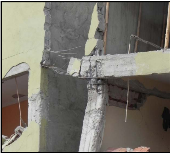
Fotoğraf/Picture 62 – Kirişte Kesme Donatısı Eksikliği / Lack of Beam Shear Reinforcement
