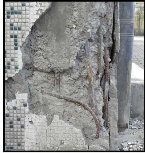
Fotoğraf/Picture 50 – Foto.49 daki Binada Göçen Perde Başı / Compression failure in the Shear Wall of Bldg. in Pic. 49
