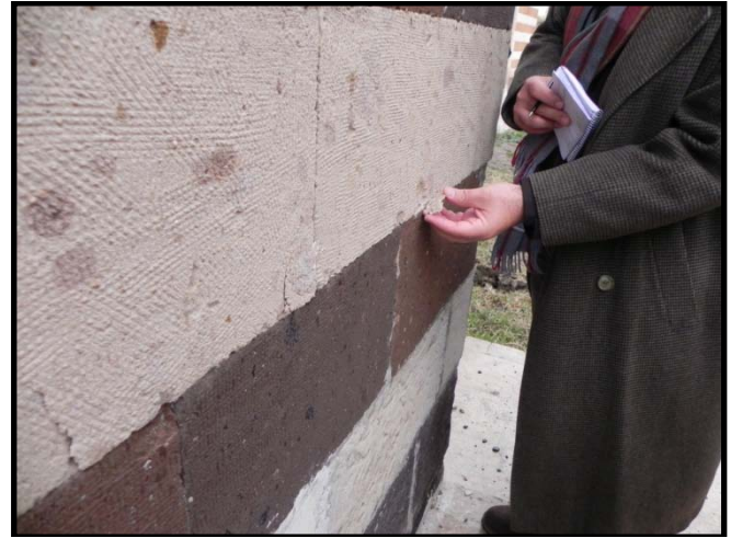
Fotoğraf/Picture 6 – Kare Minare Kaidesinin Batı Yüzündeki Taş Ezilmeleri / Compressive Crushing on the Western Minaret Pedestal Walls
