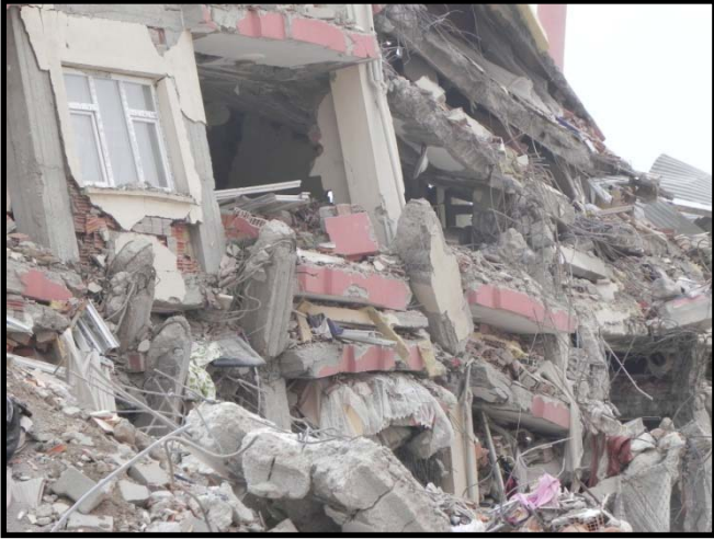
Fotoğraf/Picture 59 – Yetersiz Filiz Boyu ve Etriyersiz Düğümünden Oluşan Hasar / Failure due to Inadequate Lap Splice Length and Confinement in Joints
