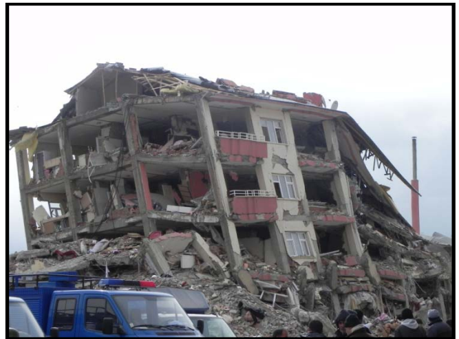
Fotoğraf/Picture 58 – Ercište Düğüm Bölgesi Hasarıyla Göçen Bina 2 / Total Collapse due to Joint Failure in Ercis 2
