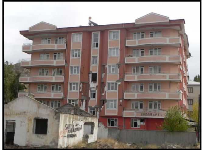
Fotoğraf/Picture 56 – Ercište Çift Tuğla İzolasyonlu Cephe Duvarı Hasarı 2 / Façade Wall Damage in Double Walls – Ercis 2
