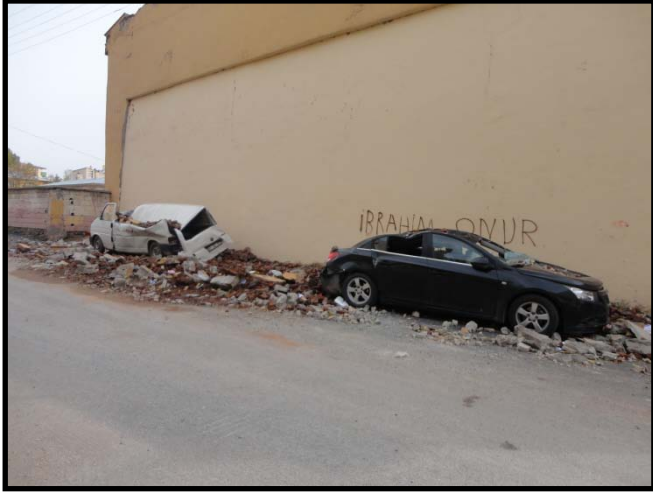
Fotoğraf/Picture 69 – Kalkan Duvar Hasarı ve Sonuçları / Failure of Gable Walls and the Resulting Secondary Damage
