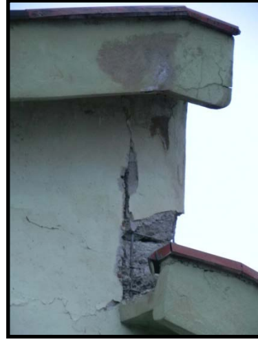
Fotoğraf/Picture 24 – Kısa Kolon Hasarı / Damage due to Short Column
