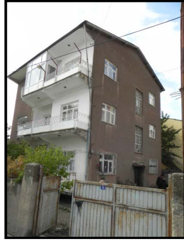
Fotoğraf/Picture 54 – Minimal Hasarlı Çimento Harçlı Tuğla Yığma Yapı / Minimum Damage in Brick Masonry with Cement Mortar Building
