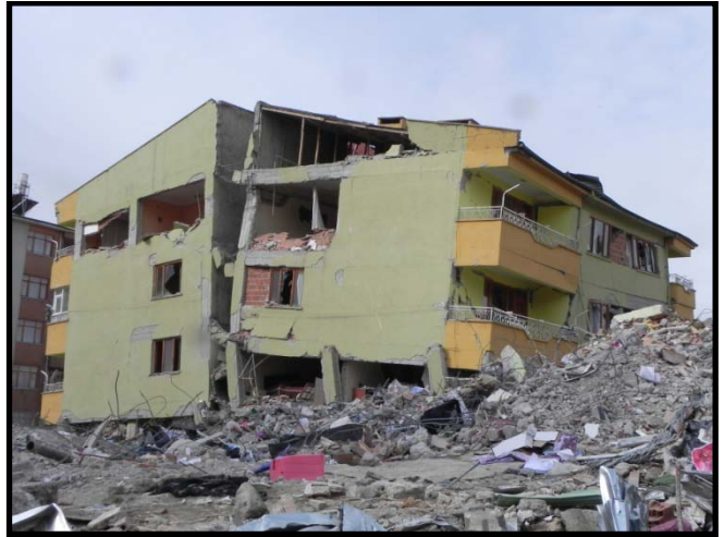
Fotoğraf/Picture 61 – Kesme ve Sargılama Donatılarının Eksikliğinden Oluşan Göçmeler / Failure due to Lack of Shear and Confining Reinforcement
