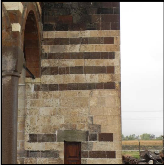
Fotoğraf/Picture 13 – Minare Kaidesinde Kesme Çatlakları / Shear Failure of the Minaret Pedestal
