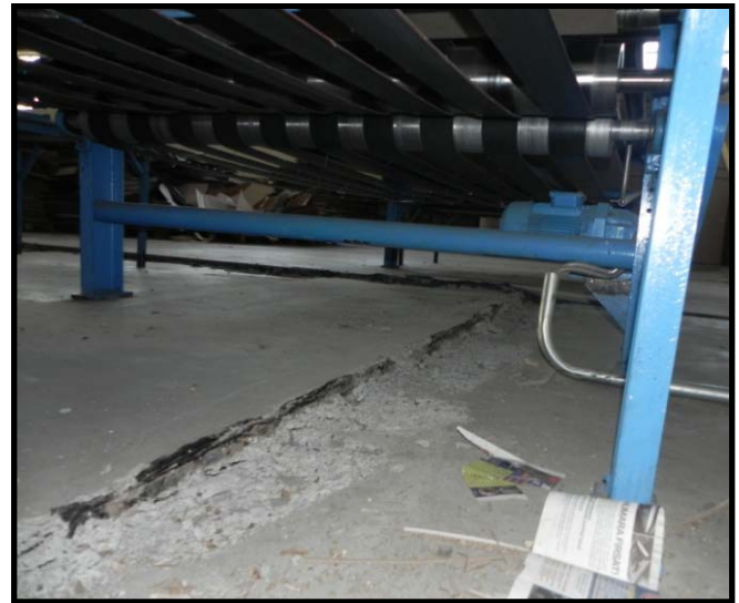
Fotoğraf/Picture 78 – Döşemelerde Kabarma / Heaving of the Concrete Factory Floor
