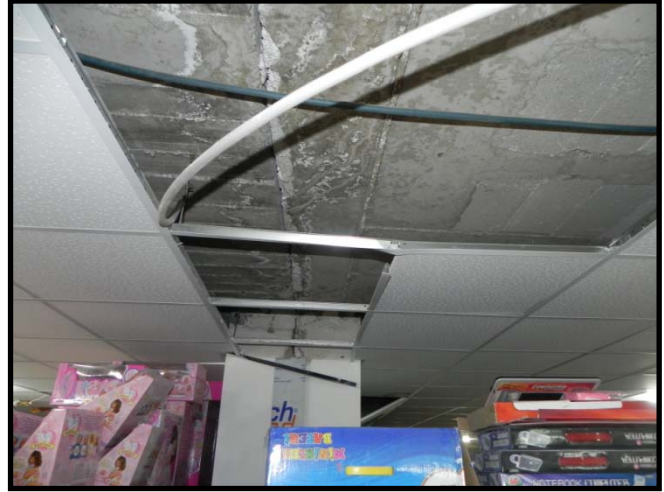
Fotoğraf/Picture 70 – Asma Tavan Kaplamasının Dilatasyon derzinde de Devam Etmesi Kozmetik Hasara Sebep Olmuş / The Continuity of the False Ceiling over the Expansion Joint Resulted Damage in Non-structural Members
