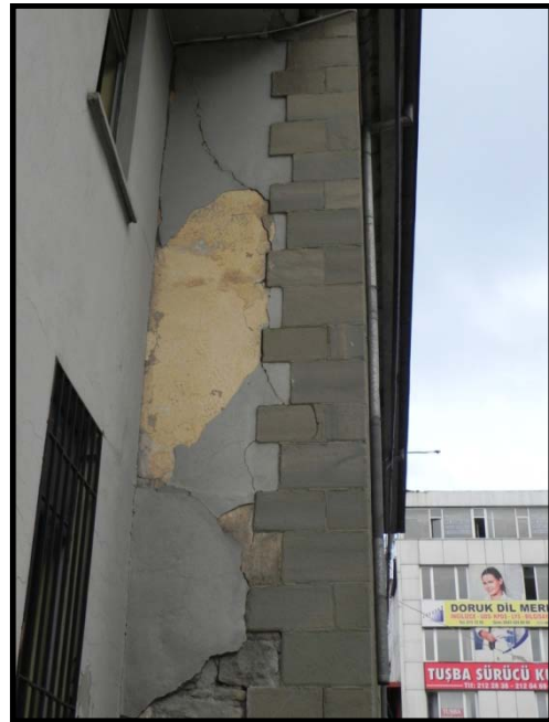
Fotoğraf/Picture 26 - Duvar hasarı (düşey çatlak) / Damage on Wall (vertical cracks)
