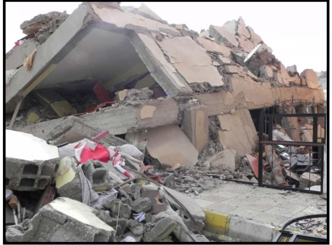
Fotoğraf/Picture 60 – Düğüm Bölgesi Hasarı-Gevrek Göçme/ Joint Failure-Brittle
