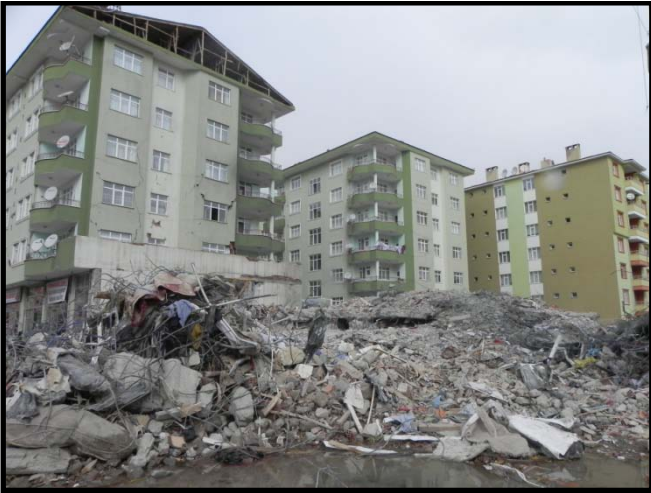
Fotoğraf/Picture 60 – Aynı Bölgede Tamamen Göçmüş ve Az Hasarlı Binalar / Failed and Minimum Damage Buildings in the Same Area
