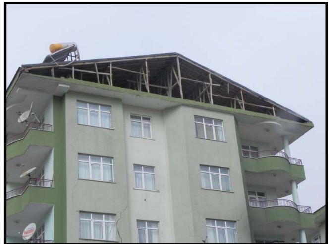
Fotoğraf/Picture 69 – Kalkan Duvar Hasarı / Failure of Gable Walls
