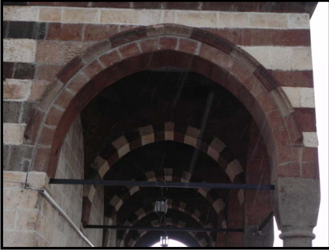
Fotoğraf/Picture 11 – Son Cemaat Yerinde Kemerlerin Beden Duvarına Oturduğu noktalarda gözlenen Çekme ve Ezilme Hasarları / Tensile and Crushing Type of Failures on the Arches at the Connection to the Peripheral walls
