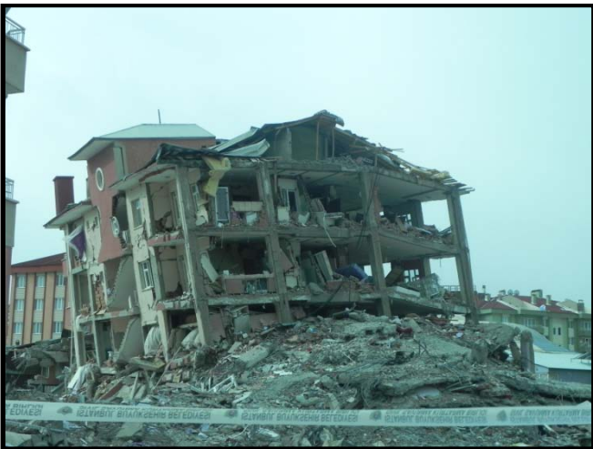
Fotoğraf/Picture 57 – Ercište Düğüm Bölgesi Hasarıyla Göçen Bina 1 / Total Collapse due to Joint Failure in Ercis 1
