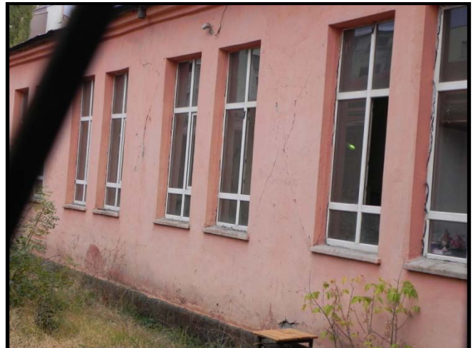
Fotoğraf/Picture 22 – Atölye Cephesi Kesme Çatlakları / Shear Cracks on the Workshop Build. Facade
