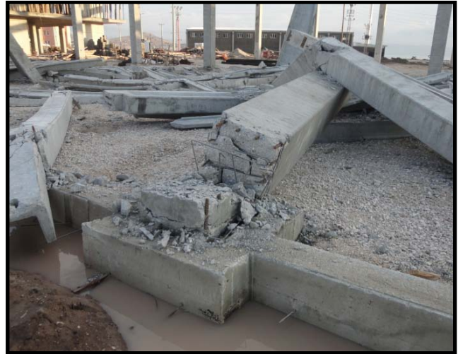
Fotoğraf/Picture 82- Donatı Kopması ile Oluşan Kolon Göçmesi / Reinforcement Rupture and Column Failure
