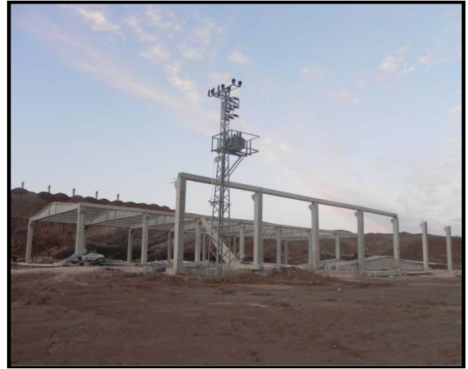
Fotoğraf/Picture 76 – Hasarlı Prefabrik Çerçeve / Failed Pre-Cast Concrete Frame
