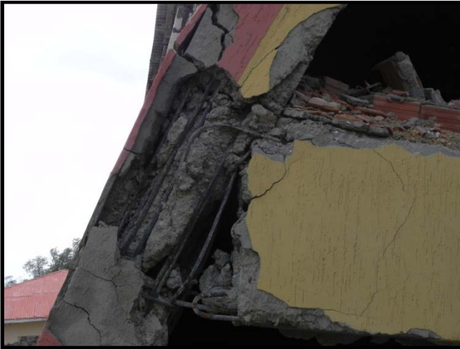
Fotoğraf/Picture 66 – Perde-Kiriş Birleşiminde Ankraj Boyu Zafiyeti ve Yerinden Çıkan Kiriş / Anchorage Failure at Shear Wall to Beam Connection
