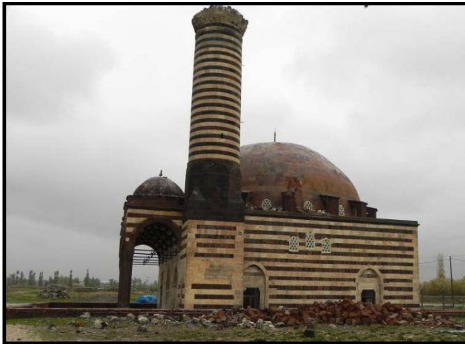
Fotoğraf/Picture 9 – Kaya Çelebi Camisinin Genel Görünüşü ve Minarenin Şerefe Üzerinden Yıkılmış Hali / Overall view of Kaya Çelebi Mosque and the Failure of Minaret above Sherefe
