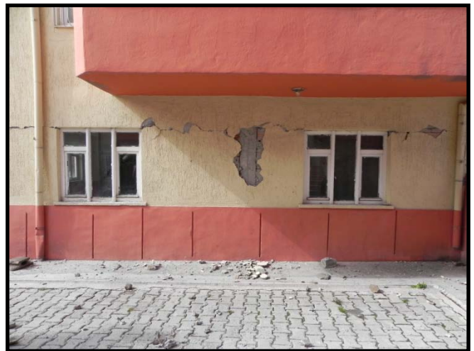
Fotoğraf/Picture 52 – Düşük Yanal Rijitlik Sebebiyle Düzlem Dışı Duvar Hareketi ve Yapısal Hasar / Wall out-of-plane Deformation and Structural Damage
