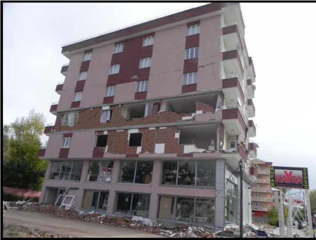
Fotoğraf/Picture 55 – Ercište Çift Tuğla İzolasyonlu Cephe Duvarı Hasarı 1 / Façade Wall Damage in Double Walls – Ercis 1
