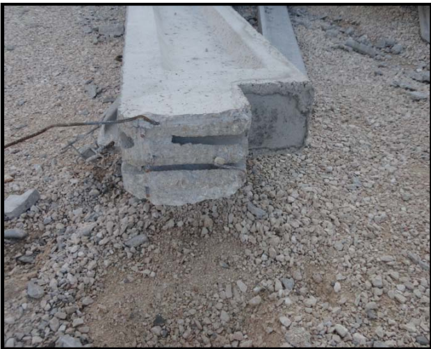
Fotoğraf/Picture 83- Detay Eksikliği ve Pim Yuvasında Göçme / Tension Failure at Rebar Hole, No Hoop Reinf.
