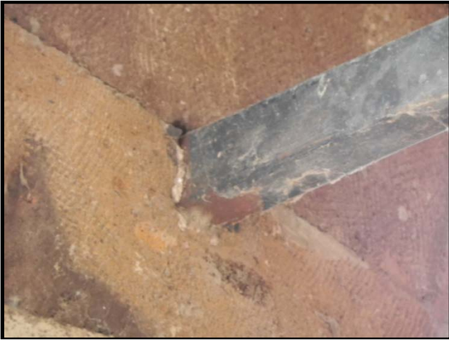
Fotoğraf/Picture 5 – Yerinden Çıkan Kemer Gergileri / Pull-out Failure of the Arch Tension Ties
